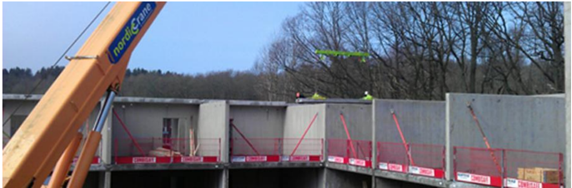
Figur 15. Montage av prefabstomme till NCCs bygge av äldreboende i Vallda söder om Göteborg
